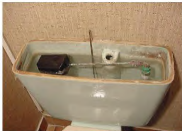
5 - Le niveau d'eau ne doit pas atteindre le trop-plein.
