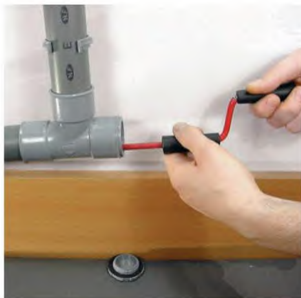
4 - Tournez la manivelle du furet pour désagréger le bouchon. Refermez et faites couler de l'eau chaude.
